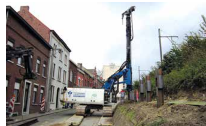
Voor de aanleg van een fietspad in Nijvel diende een deel van een bestaand spoorbermtalud weggegraven te worden. Dit gebeurde door middel van een berlinerwand met versterkte betonplaten.
