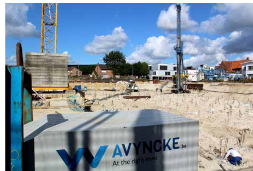
Dankzij de opname in de groep van de firma A. Vyncke in maart 2017 kan Votquenne Foundations bemalingstechnieken gecombineerd aanbieden met de funderingen en beschoeiingen.
