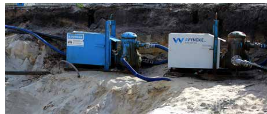
Voor de bouw van dit gemeenschapscentrum in Brugge heeft A.Vyncke de bemaling geplaatst en Votquenne Foundations de paalfundering en de verankerde berlinerwanden uitgevoerd.
